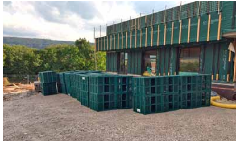
Eléments du puits perdu
