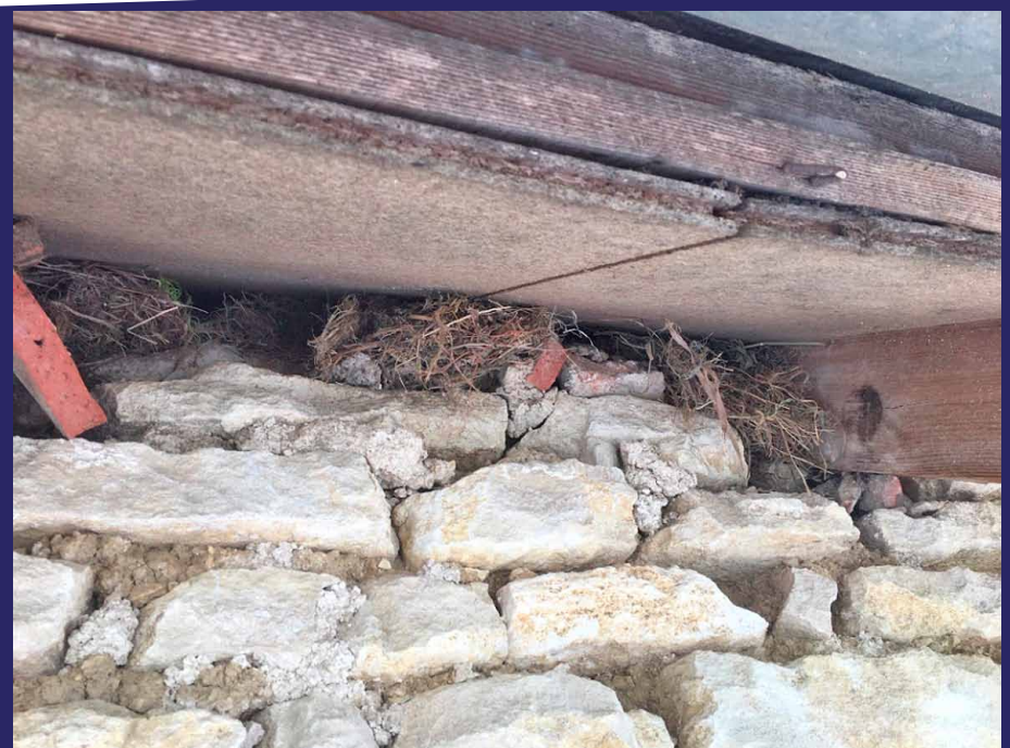
Nid entre la toiture et le mur
